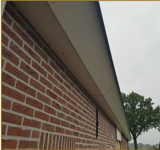
Afb. 2.7: Strak aansluitend houten overstek voorkomt dat vleermuizen in de spouwmuur van het te slopen woongebouw kunnen klimmen.
