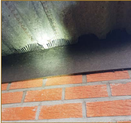
Afb. 2.7: Vogelschroot onder de golplaten daken van gebouw 3. Bij andere te slopen gebouwen waren die ook aanwezig.
