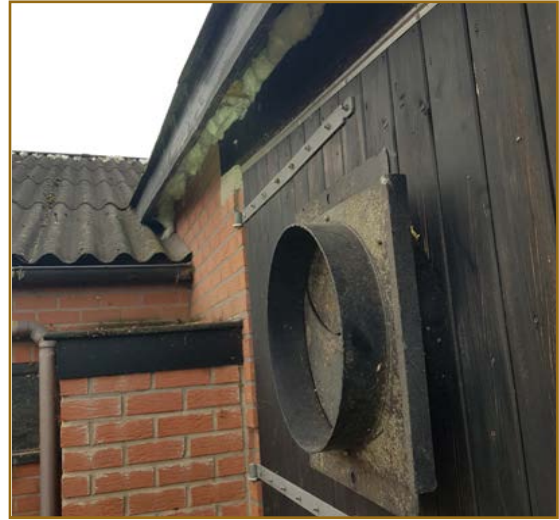
Afb. 2.14: Spouwmuur van gebouw 4 geblokeerd door purschuim
