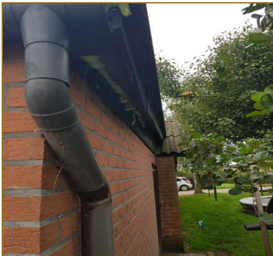
Afb. 2.15: Purschuim aan de westkant van gebouw 4.
