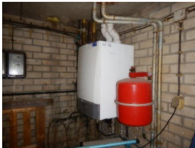
Cv-ketel niet asbesthoudend
