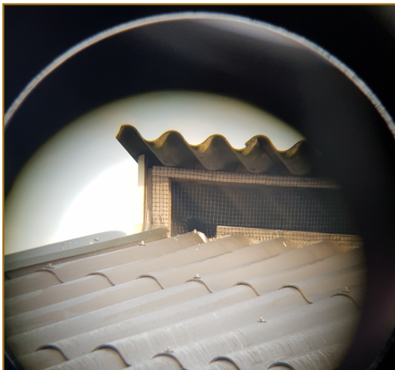
Afb. 2.3: Gat in het gaas waardoor mussen naar binnen kunnen.
