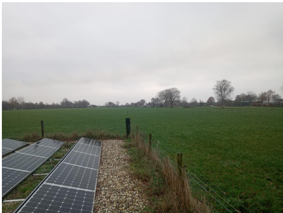
Foto 1: Zonnepanelen en bouwvlak
