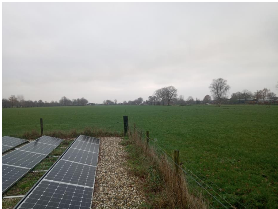
Foto 1: Zonnepanelen en bouwvlak
