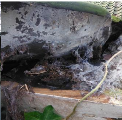
Doek onder dakpannen woning niet asbesthoudend
