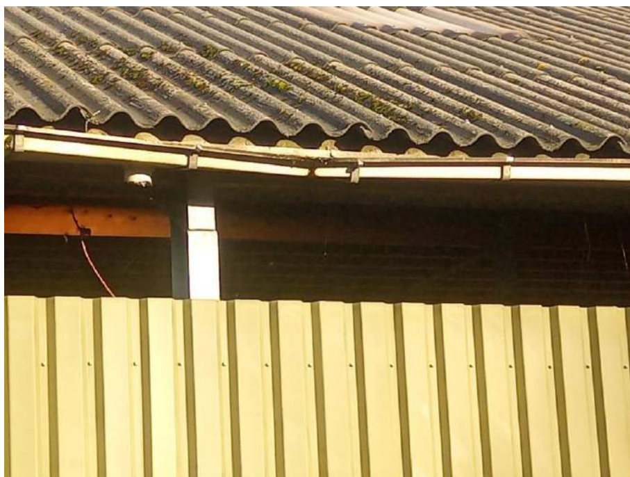
Foto 4: lekkage dakgoot oostelijke schuur
