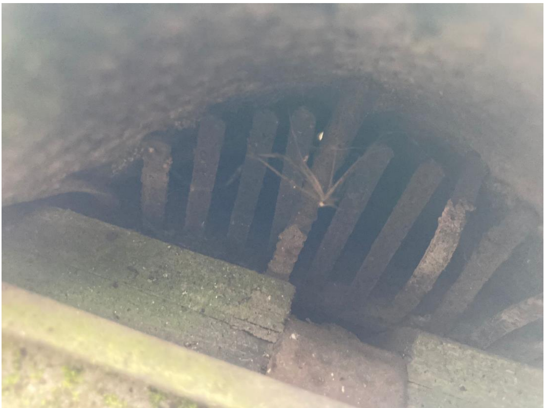
Op plaatsen is vogelschroot aanwezig om vogels en andere fauna te weren.
