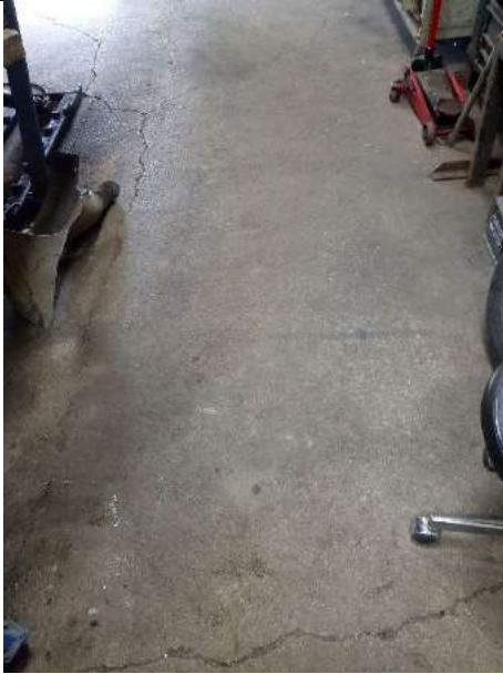
Foto 5: Verharding in de schuur
