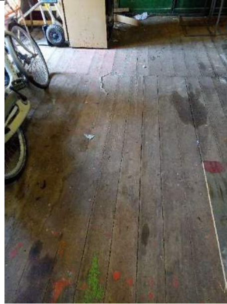
Foto 6: Verharding in de schuur
