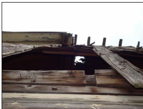
Figuur 13. Aan de westzijde is de zolder grotendeels open en is het dak in zeer slechte staat, waardoor veel gaten zijn ontstaan in het dak.
