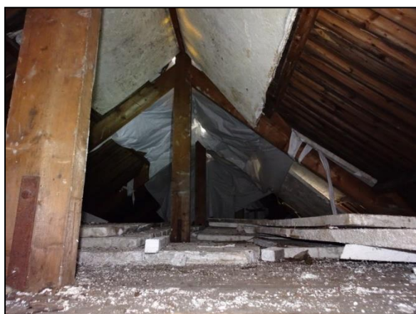
Figuur 10. Het dakbeschot is op veel plaatsen weggerot en vervangen door zeil.
