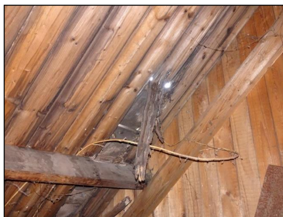
Figuur 11. Het dak is op veel plaatsen lek.
