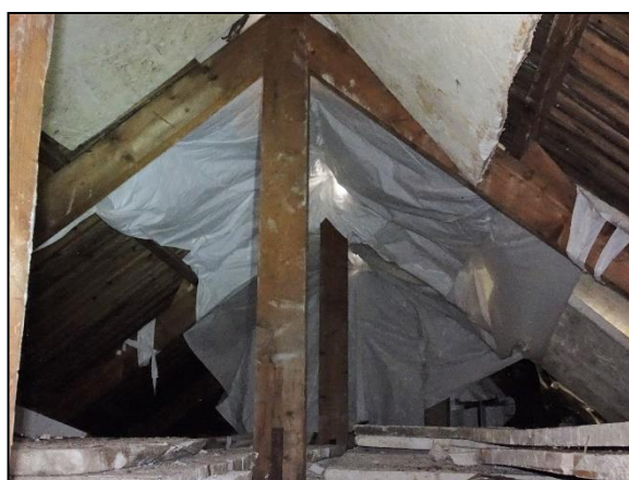
Figuur 15. Op veel plaatsen is het weggerotte dakbeschot vervangen door wit zeil.
