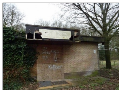
Figuur 8. Voormalige clubgebouw met plat dak in vervallen staat.
