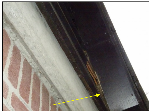
Figuur 22. Oud nest in elektriciteitshuisje.
