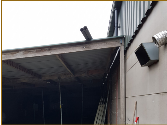
Afb. 2.5: Overzichtsfoto van de plaats waar de vleermuizen onder de metalen gevelbekleding kunnen komen.
