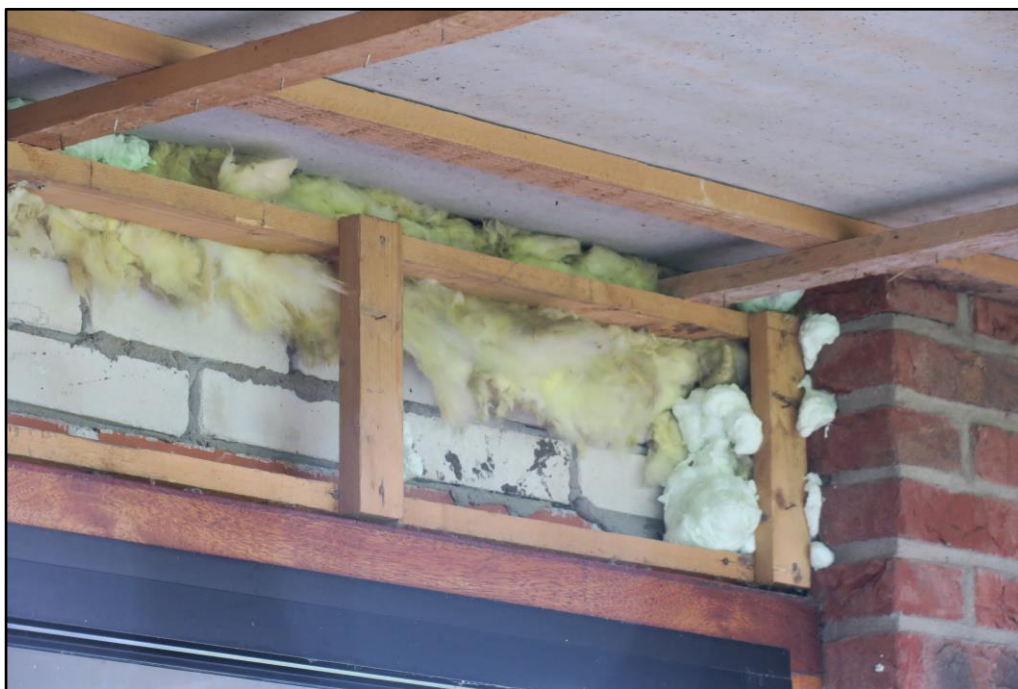
Figuur 2 De spouw van de woning bevat spouwisolatie in de vorm van glaswol en schuim.
