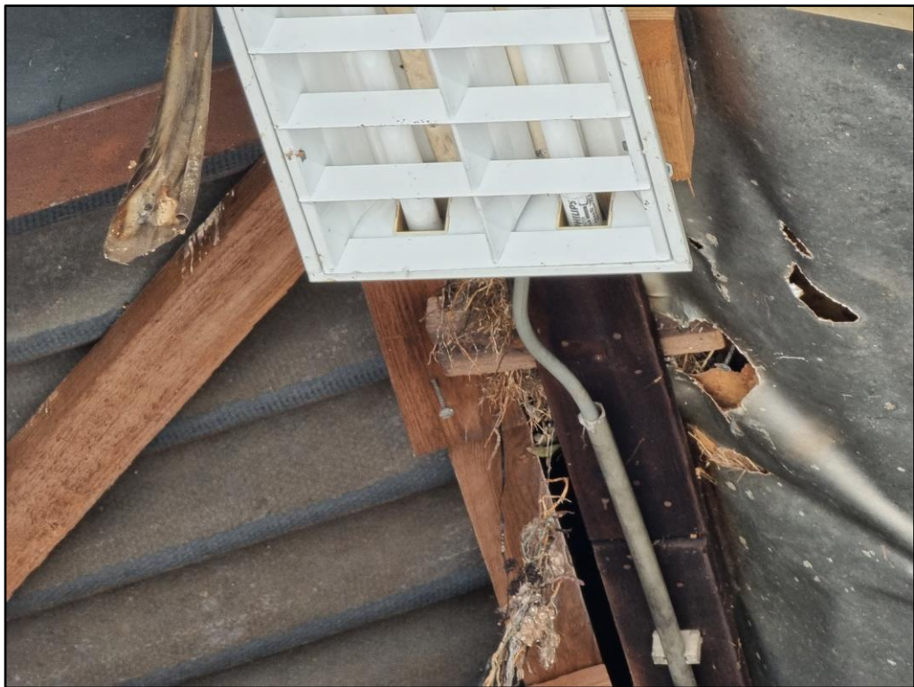
Figuur 4 Het dak boven de stal bevat op verschillende plaatsen nestmateriaal.
