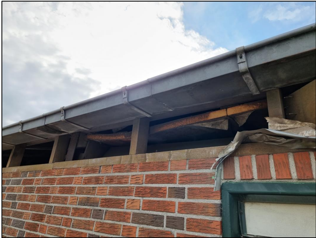
Figuur 3 De dakranden zijn op verschillende plaatsen open waardoor er geen geschikt microklimaat aanwezig is voor gebouwbewonende vleermuizen.
