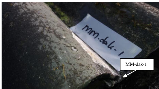
Foto 1: Asbesthoudende golfplaat als dakbedekking van de kalverstal.
