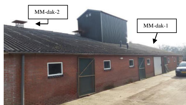
Foto 4: Geïntervieweerde kalverstal met asbesthoudende golfplaat als dakbedekking vanuit noordwestelijke richting gezien. Tevens asbesthoudend plaatmateriaal aan ventilatiekokers zichtbaar.
