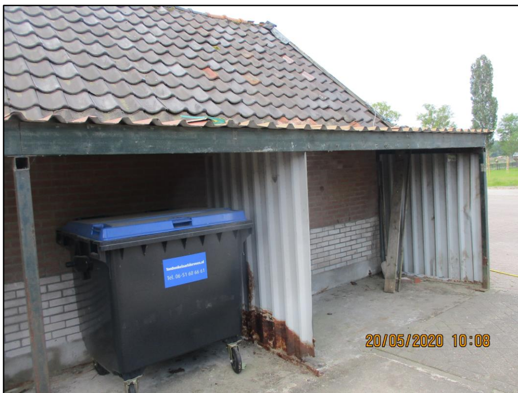
Figuur 3 Overkapping van metalen damwand aan de te saneren schuur op de planlocatie.
