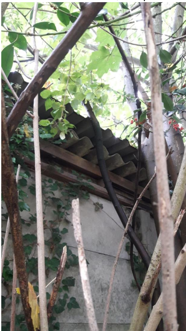
Schuur met asbestverdacht dak, oostzijde onderzoekslocatie
