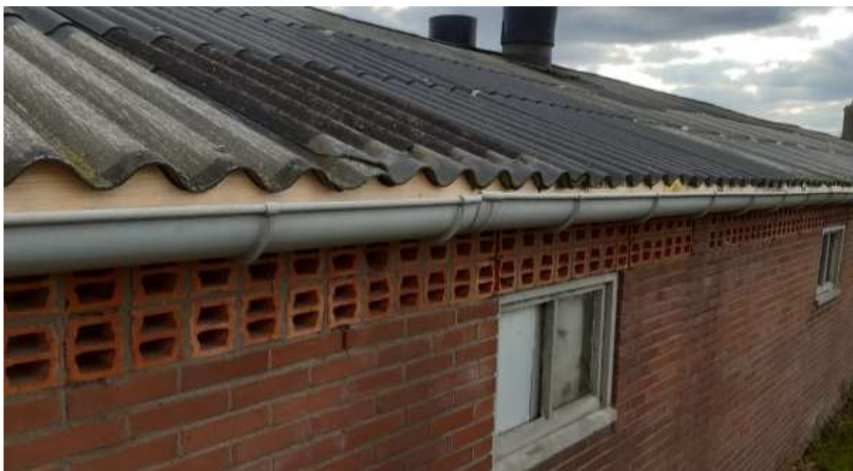
Vogelschroot/isolatie t.b.v. golfplaten daken
