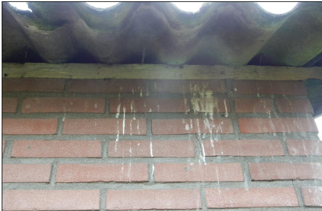
Figuur 4 Fotografische indruk de muur en het dak aan de noordzijde van schuur 1. Hier zijn krijtsproten van (vermoedelijk) spreeuwen aangetroffen.
