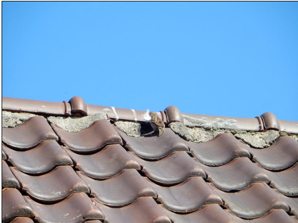
Figuur 5 Onder de nokvoorst ontbreekt een stuk cement, waardoor huismussen toegang hebben tot de ruimte tussen het dakbeschot en de dakpannen. Tijdens het veldbezoek zijn invliegende huismussen meerdere malen waargenomen.
