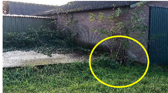
Foto 13: Noordoostelijk deel van de rundveestal: asbestverdachte dakbedekking welke ontwaterd op een onverhard terreindeel (gat 82).
