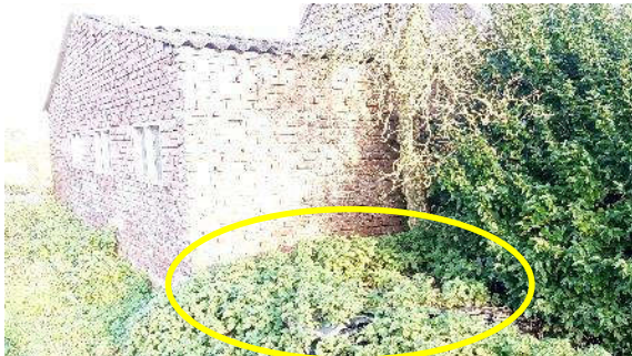
Foto 12: Zuidwestelijke hoek van de zuidelijke mestvarkensschuur: asbestverdachte dakbedekking welke ontwaterd op maaiveld (locatie gat 81).
