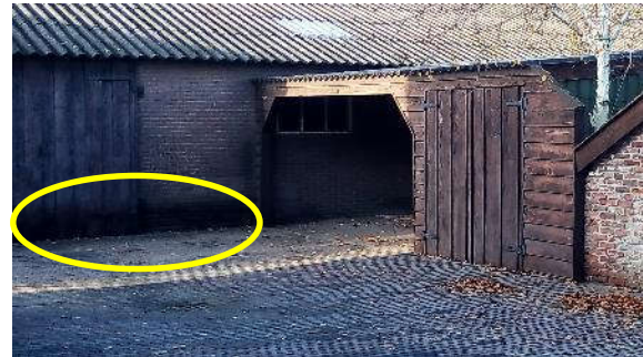
Foto 7: Verder naar het westen (dan foto 6) de rundveeschuur, de dakbedekking ontwaterd op een verharding.
