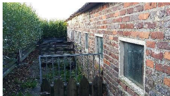
Foto 11: De zuidzijde van de zuidelijke mestvarkensschuur: asbestverdachte dakbedekking welke ontwaterd op een verharding.
