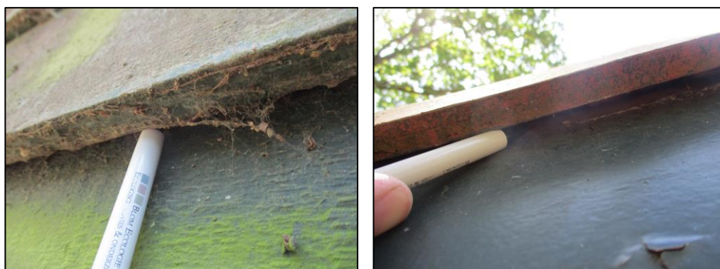
Figuur 4 Ongeschikte openingen voor in- en uitliegroutes voor vleermuizen. De pen heeft een dikte van 9 mm. Links: rabatdelen aan de noordgevel van de woning kieren heel licht, maar niet voldoende om te dienen als opening voor vleermuizen. Rechts: kantpannen aan de zuidgevel van de woning sluiten netjes aan, waardoor de ruimte niet voldoende is om te dienen als opening voor vleermuizen.
