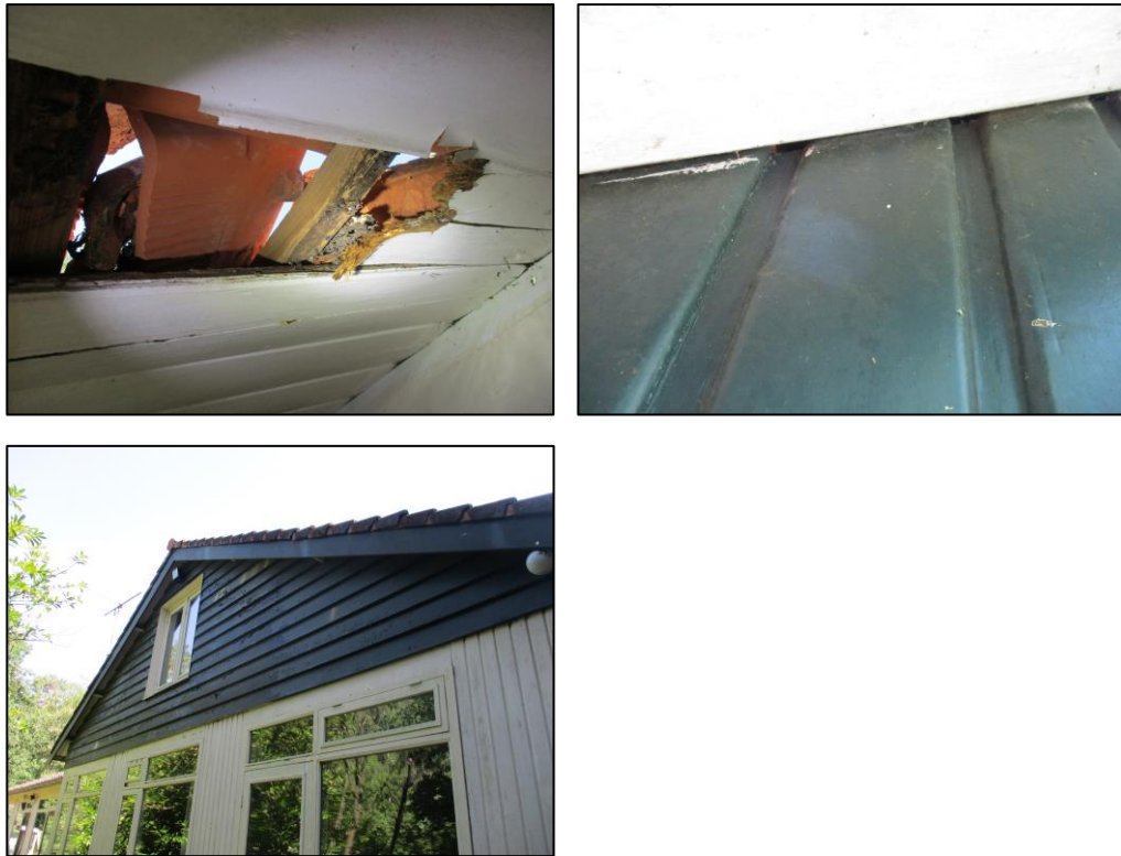
Figuur 5 Beperkt geschikte openingen voor in- en uitvliegroutes voor vleermuizen. Linksboven: kapotte plank onder het overstek van de westgevel van de woning. Rechtsboven: kleine kier tussen boeideel en gevel van de zuidgevel van schuur (C), waarbij de gevel met glas materiaal en verf is afgewerkt. Linksonder: 2 marginaal scheefliggende kantpannen aan de zuidelijke kopgevel van de woning (A).
