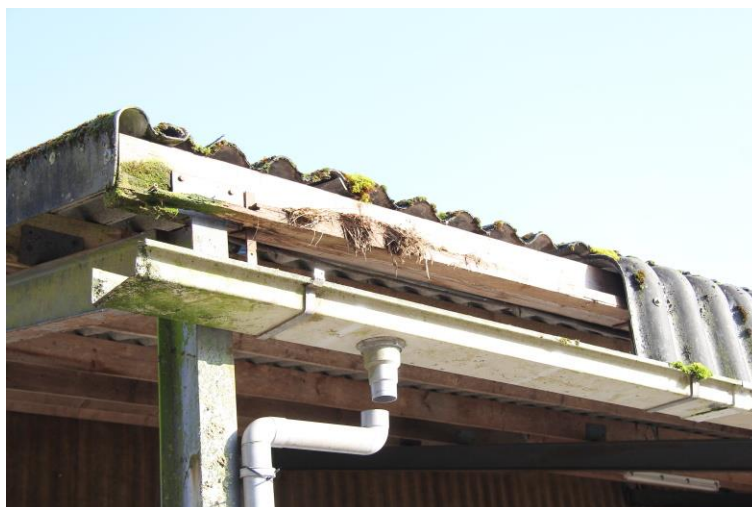
Figuur 18. Zuidwesthoek gebouw 4 met kapotte dakrand en oude mussennesten.
