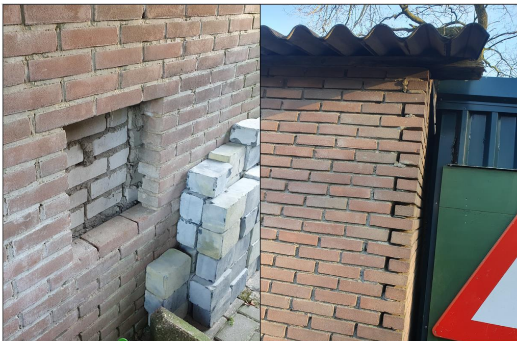
Figuur 5 Ventilatie gat aan de westelijke zijde van stal E (L) en de oostelijke zijde van de stal waar in de muur zichtbaar delen van het specie ontbreken (R).
