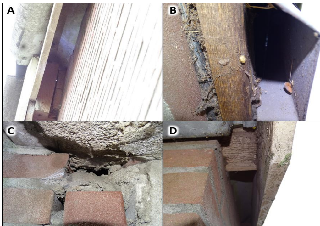
Figuur 4 De verschillende plaatsen waar de te saneren bebouwing mogelijke toegang tot achterliggende ruimten biedt. Afbeeldingen A&B geven de ruimte onder het boeibord en de gevelbeplating van schuur A weer. Afbeeldingen B&C geven gaten in de muren en ruimte achter het boeibord van schuur B weer.
