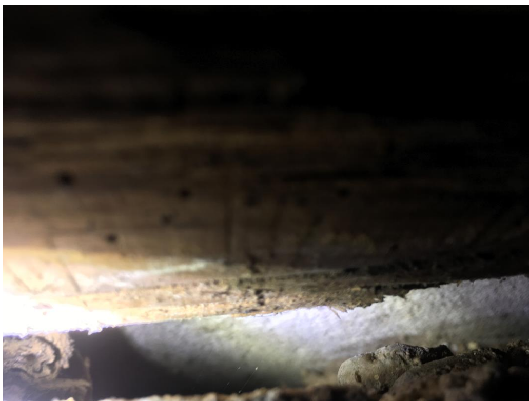
Figuur 4 De ontstane ruimte tussen de buitenmuur en betonnen muur aan de binnenzijde van schuur D. Doordat deze over de gehele lengte bovenaan open is, heerst hier geen stabiel microklimaat, hetgeen deze ruimte ongeschikt maakt voor vleermuizen.
