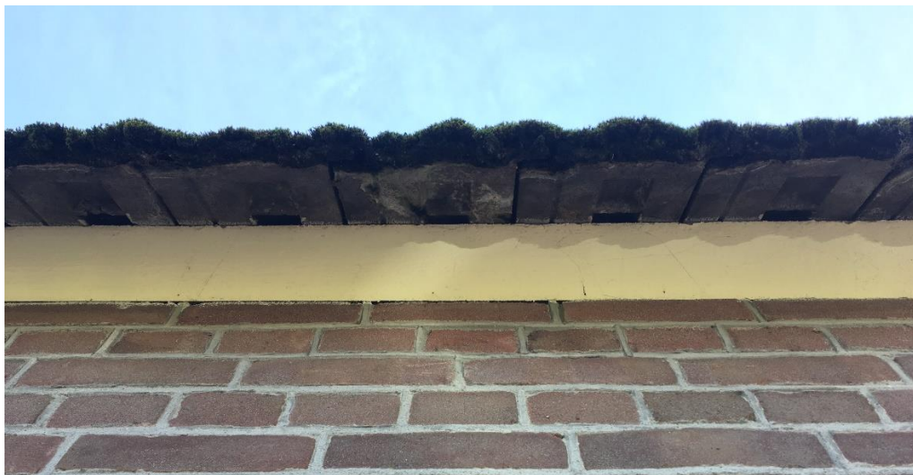
Figuur 5 De onderste rij dakpannen van gebouw B sluiten nauw aan met de muur, waardoor huismussen hier geen toegang hebben tot de ruimte tussen de dakpannen en het dakbeschot
