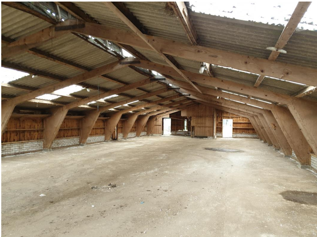
Figuur 2 Schuur is leeg zonder dakbeschot, spouw of isolatiemateriaal.
