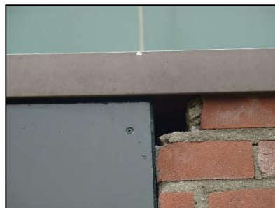
Figuur 12. Ontbreken van een stuk baksteen.
