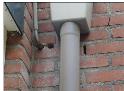
Figuur 13. Geboord gat naast de stroomkabel en een open stootvoeg.
