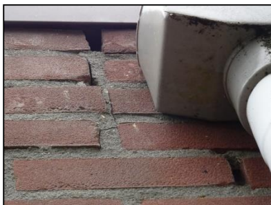
Figuur 11. Open stootvoegen in de gevel.
