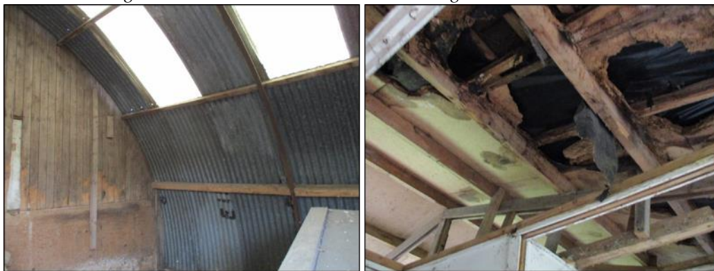
Figuur 2 (Links): De romney loods bestaat enkel uit één laag golfplaten, waardoor er geen ruimtes met stabiel microklimaat aanwezig zijn. (Rechts): De toestand van het zomerhuis is vervallen. Hierdoor zijn er grote gaten aanwezig in de daken. Door de te grote openingen is er een tochtstroom aanwezig en derhalve ontbreekt een stabiel microklimaat.
