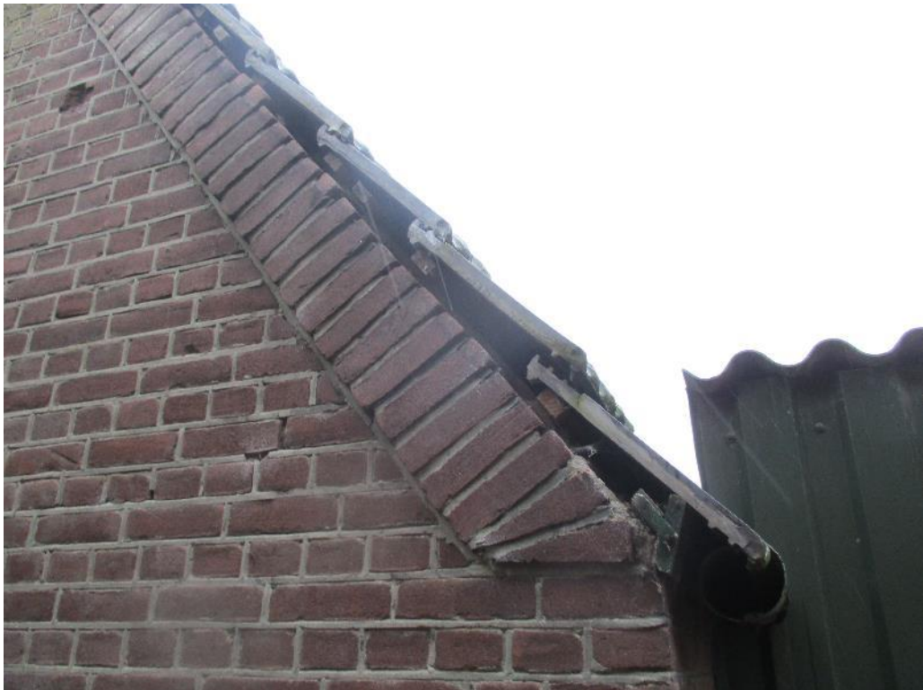
Figuur 4 Dakpannen van schuur (B). Door het ontbreken van kantpannen en isolerend dakbeschoot is hier geen geschikte verblijfplaats voor vleermuizen of broedplaats voor huismussen.
