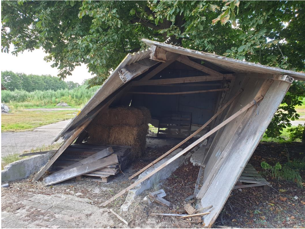
Figuur 3 Vervallen houten schuur C.
