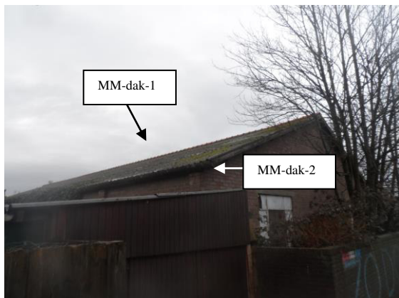
Foto 7: Asbesthoudende golfplaat en asbesthoudende dakgoot aan zuidzijde van bedrijfspand
