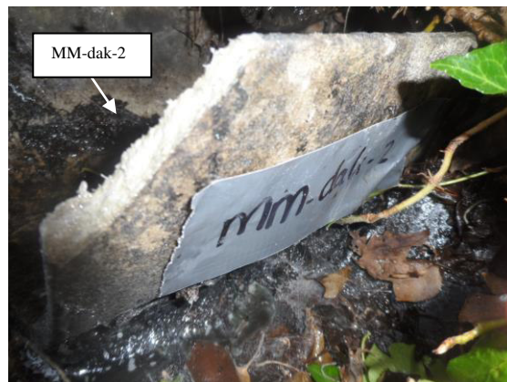
Foto 8: Asbesthoudende dakgoot t.p.v. van gedeelte bedrijfspand aan zuidzijde.
