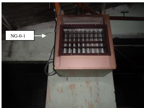
Foto 1: Asbesthoudende luchtverwarmingsinstallatie op begane grond in bedrijfspan.
