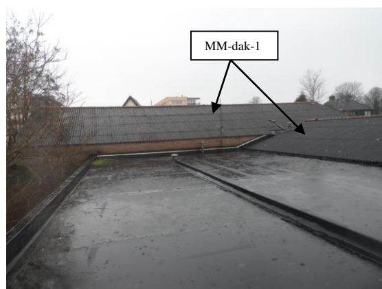
Foto 4: Asbesthoudende golfplaat als dakbedekking van bedrijfspan.
