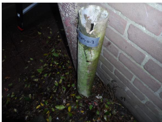
Foto 9: Asbesthoudende hemelwaterafvoer aan zuidzijde van bedrijfspand.
