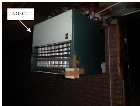
Foto 2: Asbesthoudende luchtverwarmingsinstallatie op begane grond in bedrijfspan.
