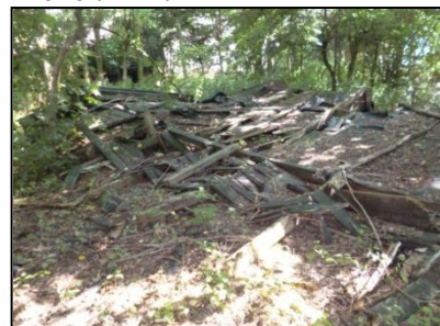
Figuur 8. Vervallen schuur (3)
