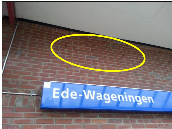
Figuur 18. Open stootvoegen stationsgebouw.
