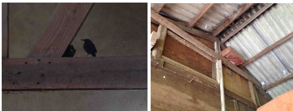
Figuur 3 In de te slopen schuren zijn jonge lijsters en een nestkist t.b.v. kerkuilen aangetroffen.
