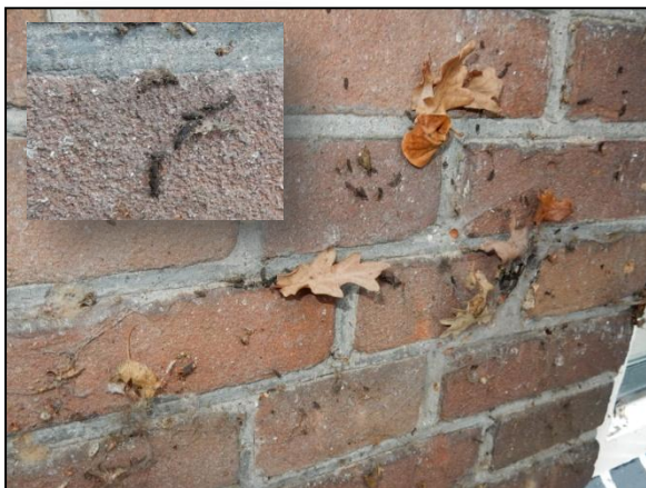
Figuur 10. Vleermuiskeutels aan de muur achter een raamluik.
