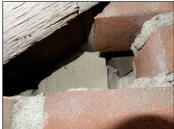
Figuur 11. Gat in muurdeel.
