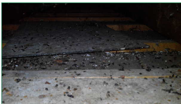
Foto 2: uitwerpselen van vleermuizen op de vloering van de woning.
