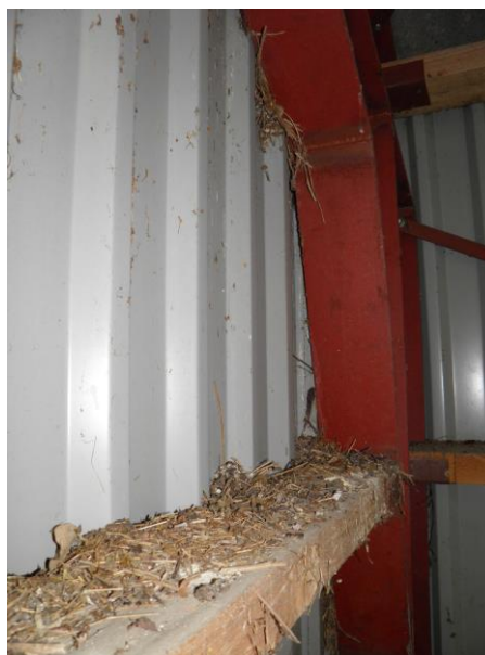
Figuur 11. Nestmateriaal, uitwerpselen en braakballen verraden het nest dat tussen de staalplaten zit.
