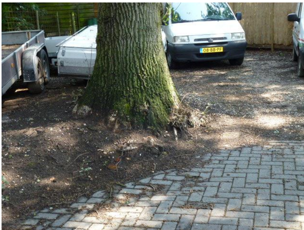
Foto 8, Door het creëren van een plantspiegel van 4 meter wordt eik 8 duurzaam behouden.
