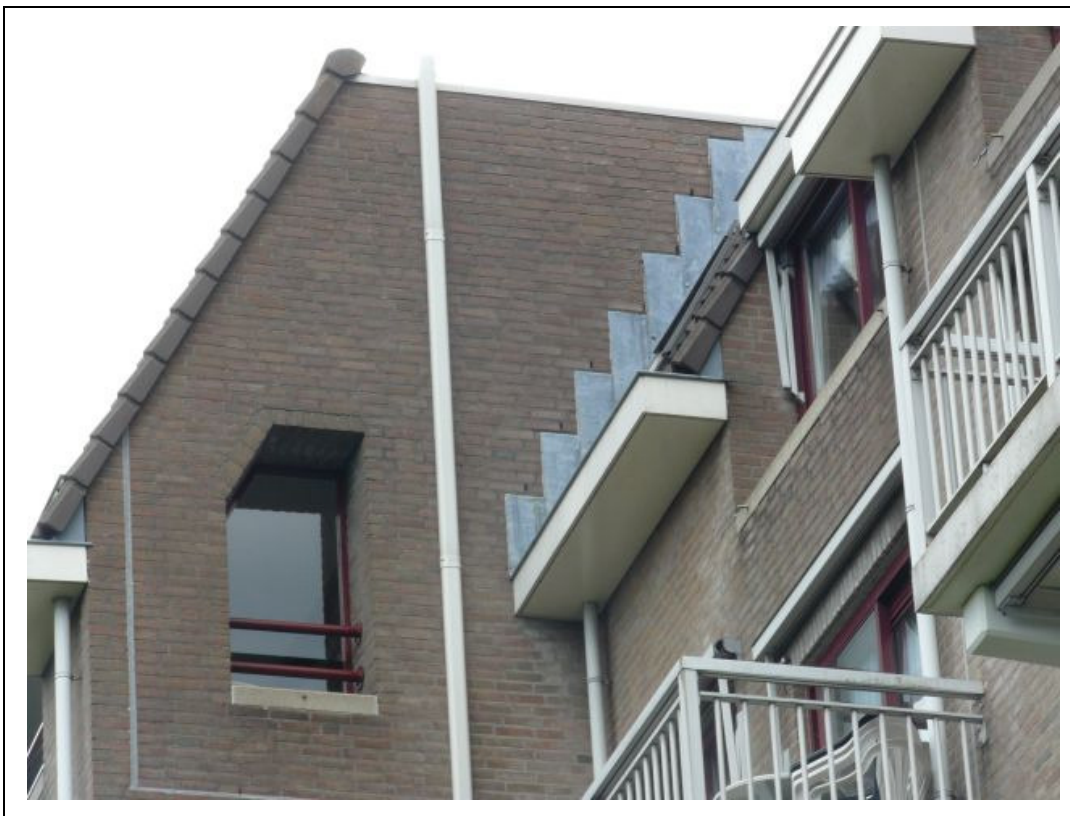
Foto 2. open stootvoegen in gevel hoofdgebouw: geschikte invliegopening voor vleermuizen
