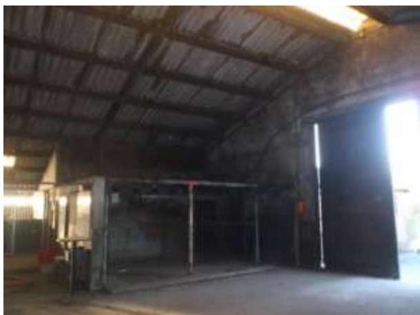
Foto 4: binnenzijde van de loopstal met inde hoek de melkstal no 8 van afbeelding 3. Alleen de melkstal heeft een beschoten kap. De ruimte tussen de isolatieplaten en de cementgebonden platen is met een endoscoop onderzocht.
