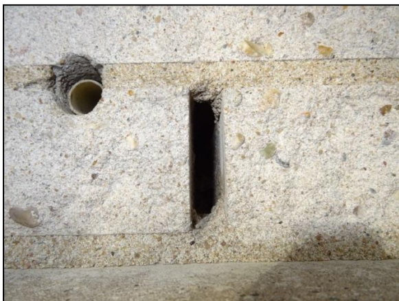
Figuur 7. Open stootvoeg die voor vleermuizen toegang geeft tot de spouwmuur.
