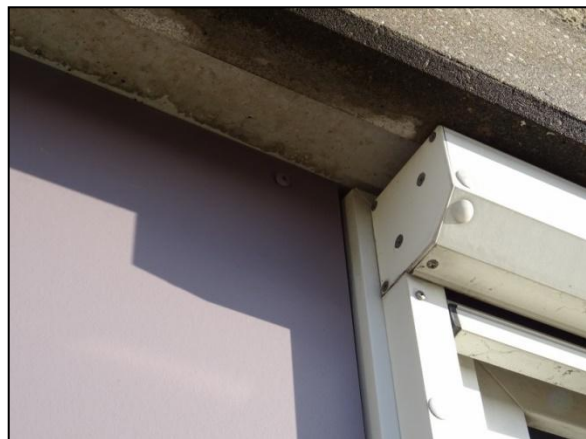
Figuur 8. Detail van de bovenzijde van de zonwering met ruimte die door gebouwbewonende vleermuizen als zomerverblijfplaats gebruikt kunnen worden.
