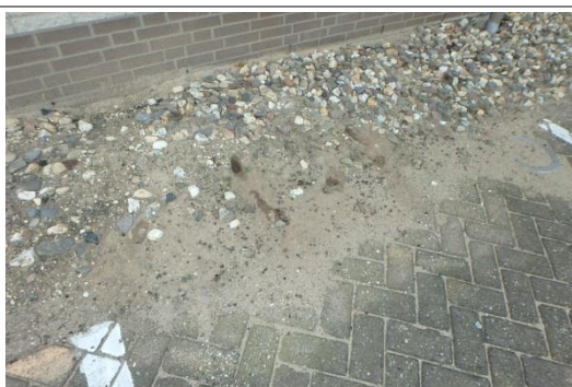
Foto 8: Aangetroffen konijnenkeutels bij de zuidoostgevel
