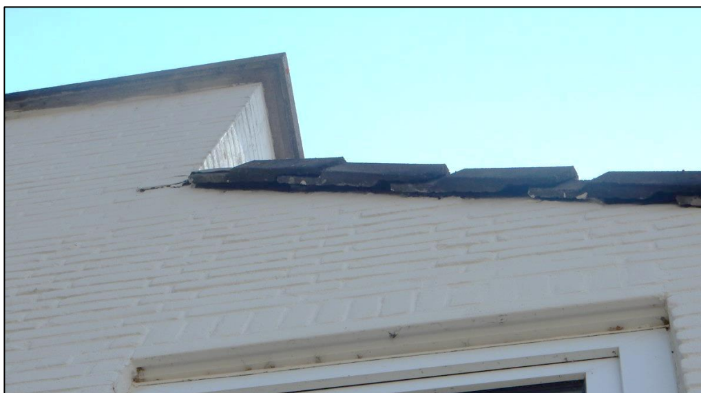
Figuur 4 Onder de kantpannen zijn op meerdere plaatsen grote kieren aanwezig welke gebruikt kunnen worden als invliegopening door vleermuizen.
