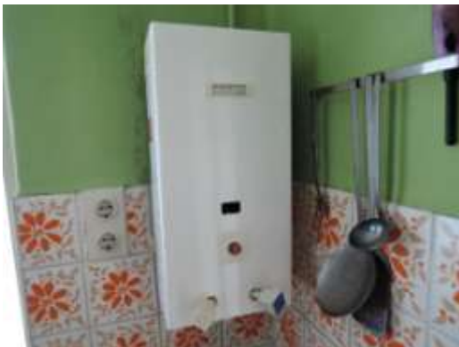
De geiser Fasto in de keuken is niet asbestverdacht.
