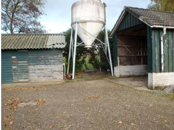
Schuur met asbestverdacht plaatmateriaal
