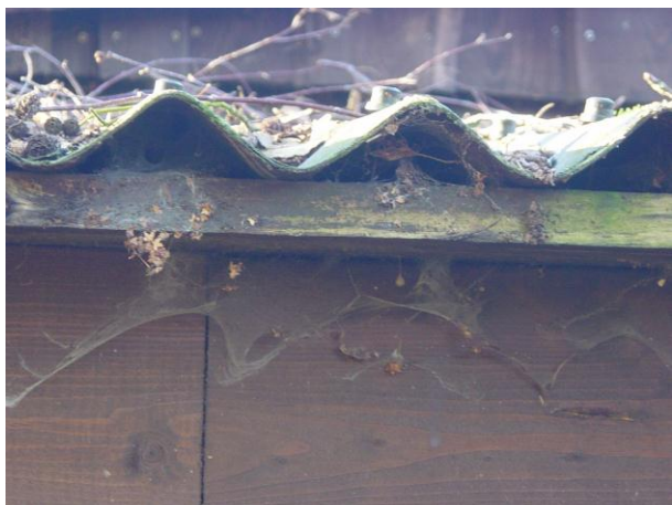
Foto 7: de undoleen platen op de uitbouw rondom de caravanstalling. Goed zichtbaar is de vele spinrag die de openingen onder de platen afdicht.
