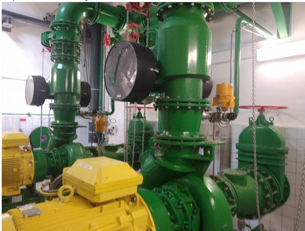
f3.1 Pompen in de kelder van het rioolgemaal
